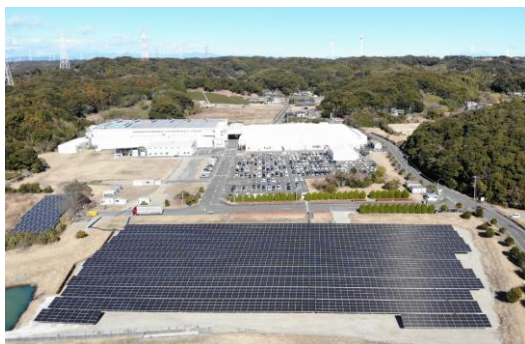
完成した太陽光発電設備
